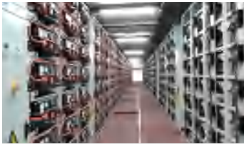
印尼莫罗瓦利工业园 (IMIP) 150 MWh
