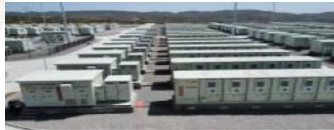
宁夏华润海原 200MWh/400MWh
