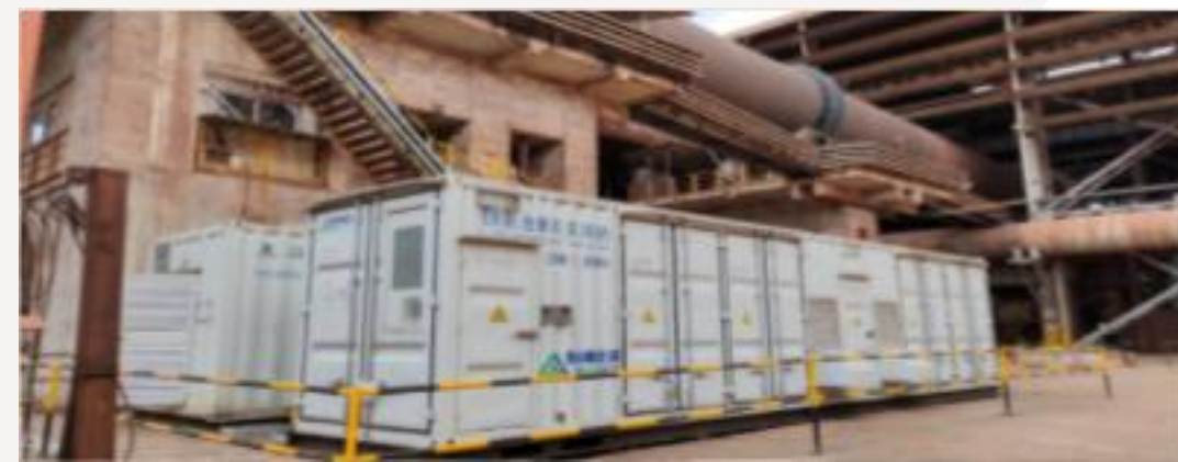
印度尼西亚Weda Bay 电网调频 IWIP项目 II, III期28MWh
