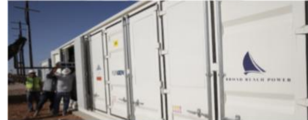
“Cascade” 储能项目117.5MWh 美国加利福尼亚州
