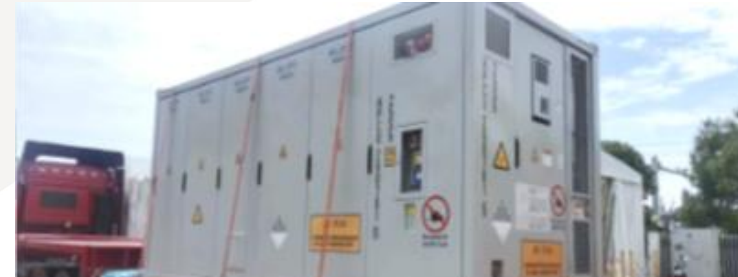
保加利亚7.45MWh光伏配储
