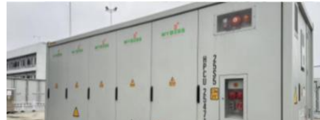
“MY BESS”项目 马来西亚 样品 3.7 MWh
